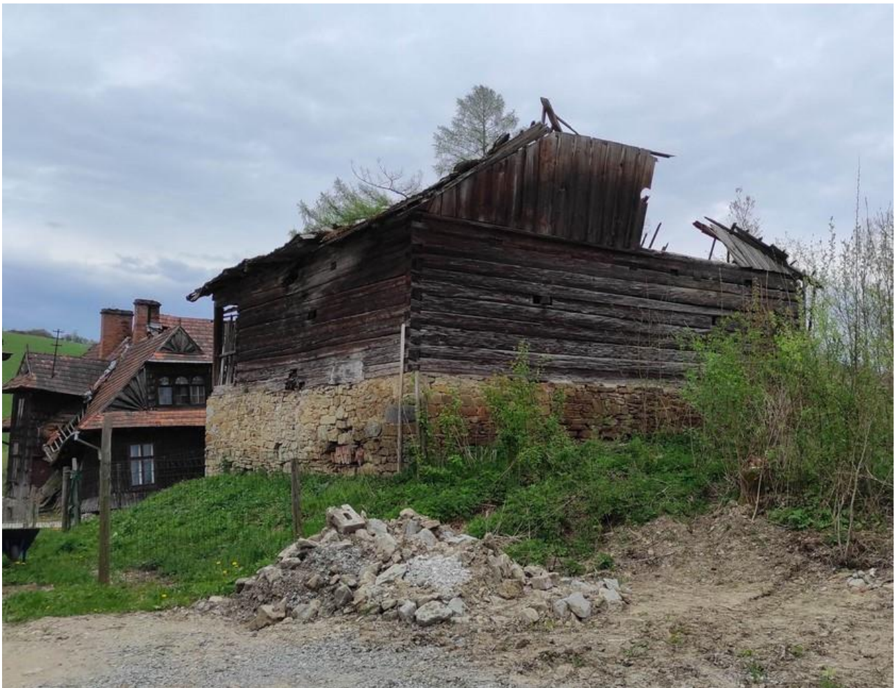
Plebania i spichlerz. Obu budynkom grozi zawalenie.
